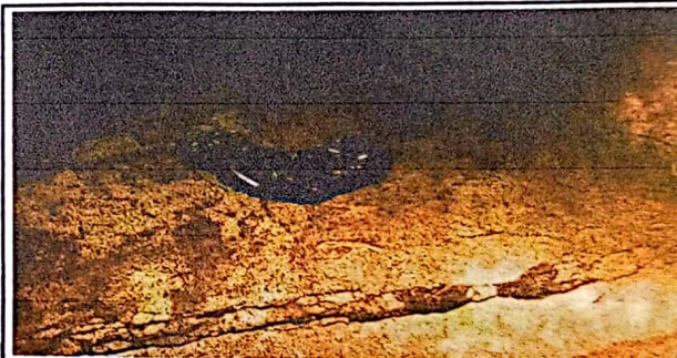
Foto 4: Se observa piso agrietado
